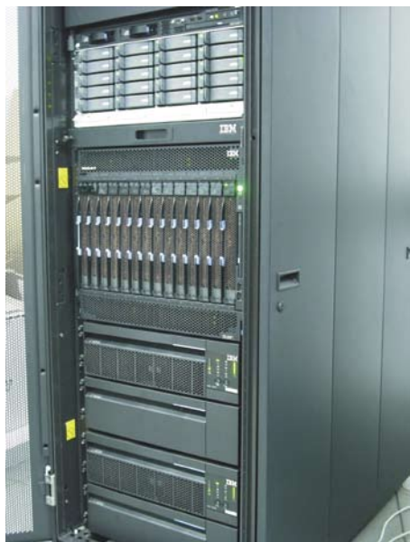
Fot. 19. Klaster komputerowy składający się z 14 serwerów w obudowie IBM BladeCenter H wyposażonych po dwa cztero-rdzeniowe procesory (łącznie 112 rdzeni obliczeniowych), macierz dyskowa 6TB, serwer zarządzający oraz zasilacze awaryjne
