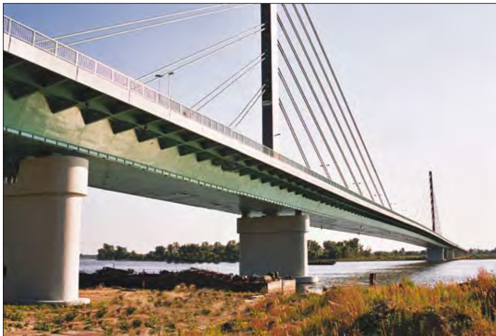
Fot. 52. Most im. Solidarności — widok na betonowe podpory z prawego brzegu rzeki
