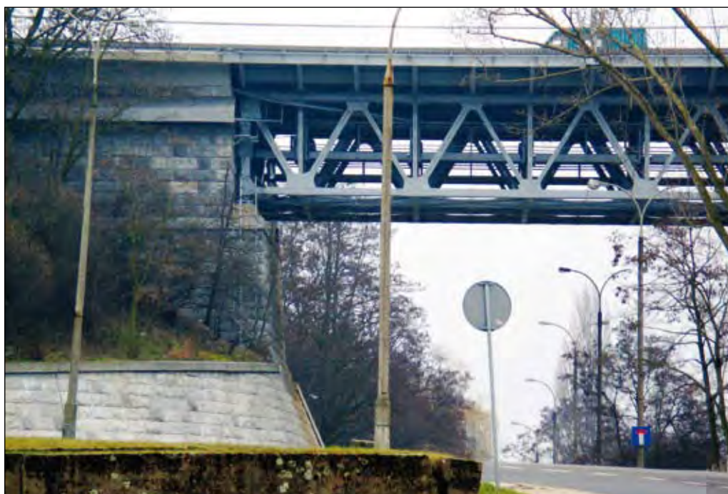
Fot. 55. Przyczółek most im. Legionów Marszałka Józefa Piłsudskiego. Widok od ul. Rybaki
