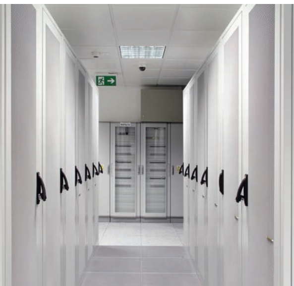
JEDNA Z SERWEROWNI W CENTRUM DANYCH ATMAN
