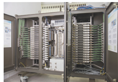
Zabudowa aparatury nadawczo-odbiorczej anteny
