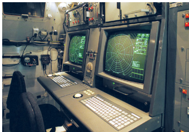
Stanowiska operatorów radaru N 23N
