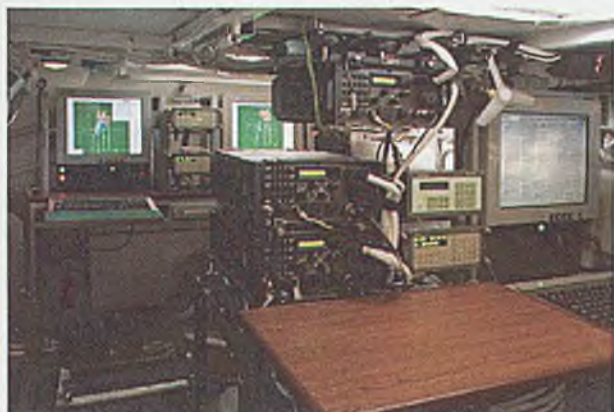
Rys. 10.13. Wnętrze kabiny operacyjnej wozu ŁOWCZA 3
