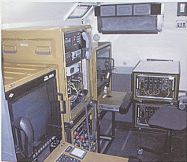
4.5. Stanowisko operatora radaru RM-100
