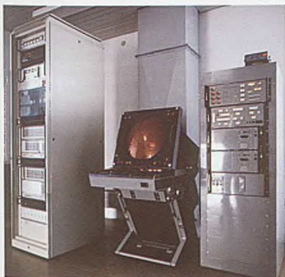
Rys. 9.3. Kabina operatora stacji AVIA CM w wieży podantennej
