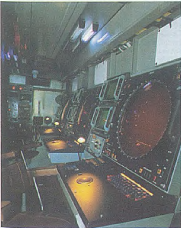
Rys. 10.8. Obiekt DP-20 (DP-40). Widok na zautomatyzowane stanowiska pracy w zunifikowanej kabynie
