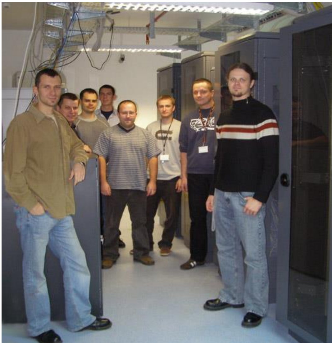
W nowej serwerowni po zainstalowaniu sprzętu
